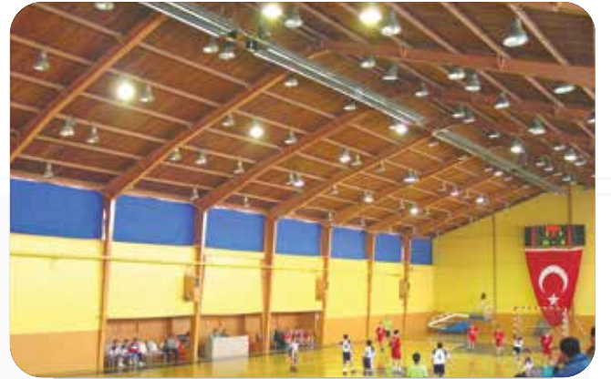
Spor Salonu Uygulaması: U Tip Üniter Sistem - Genel Isıtma
