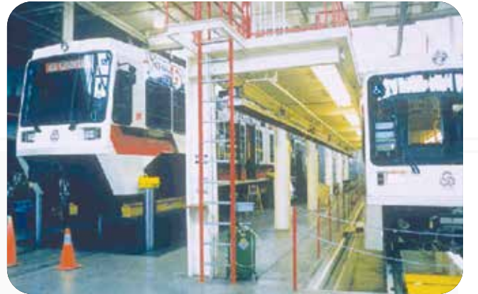
Metro Bakım İstasyonu Uygulaması: Seri Yakıclı Sistem - Genel Isıtma
