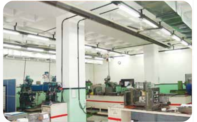
Atölye Uygulaması: Düz Tip Üniter Sistem – Genel Isıtma
