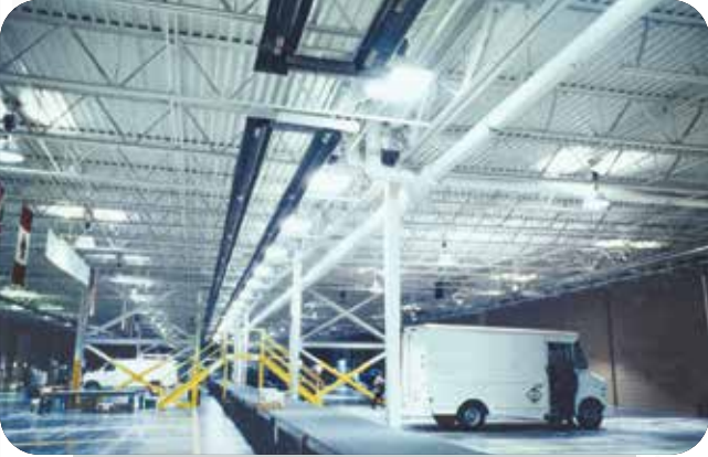
Depo Uygulaması: Seri Yakıclı Sistem - Genel Isıtma
