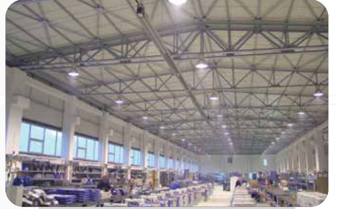
Fabrika Uygulaması: Düz Tip Çok Yakıclı Sistem - Genel Isıtma
