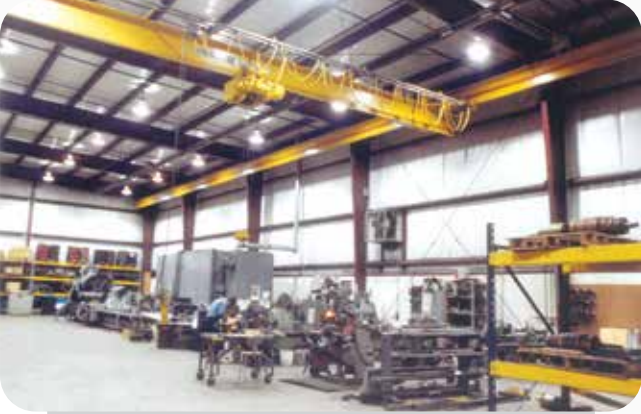
Fabrika Uygulaması: Seri Yakıclı Sistem - Genel Isıtma
