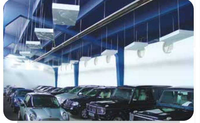
Showroom Uygulaması: Seri Yakıclı Sistem - Genel Isıtma
